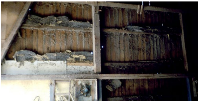
Om råttorna kommer in i en mineralullisolerad vägg kan det se ut så här bakom väggbeklädnaden efter några år.
