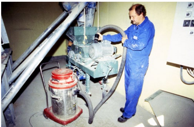
I foderberedningsanläggningar, spannmålslager och liknande utrymmen samlas stora mängder damm och boss. Rengör dessa utrymmen regelbundet. Tjocka lager av damm på arbetande motorer kan orsaka varmgång och antändning.
