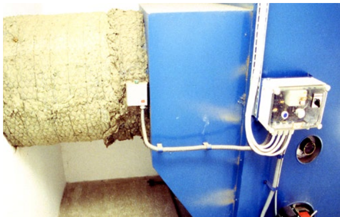
Varmluftskanalen i pannrummet ska alltid vara isolerad.
