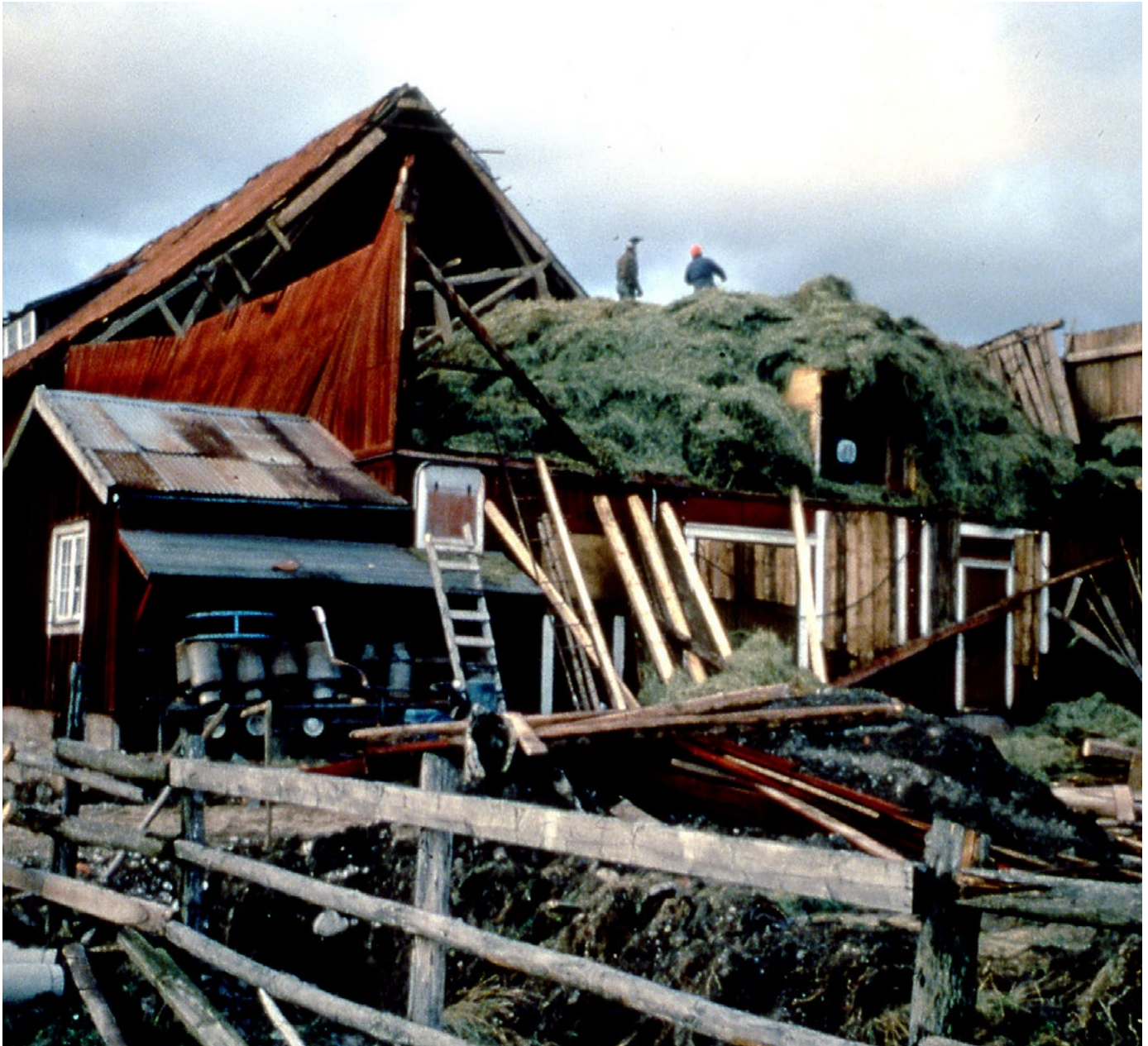
Gör du ett felaktigt ingrepp i den bärande stommen, och det förorsakar en skada, gäller inte försäkringen.
