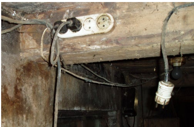
Gummikablar får aldrig ersätta den fasta installationen. Gummikablar får endast användas för tillfälliga anslutningar av flyttbara maskiner och apparater. Läs mer om detta i kapitel 4 El och åska.
