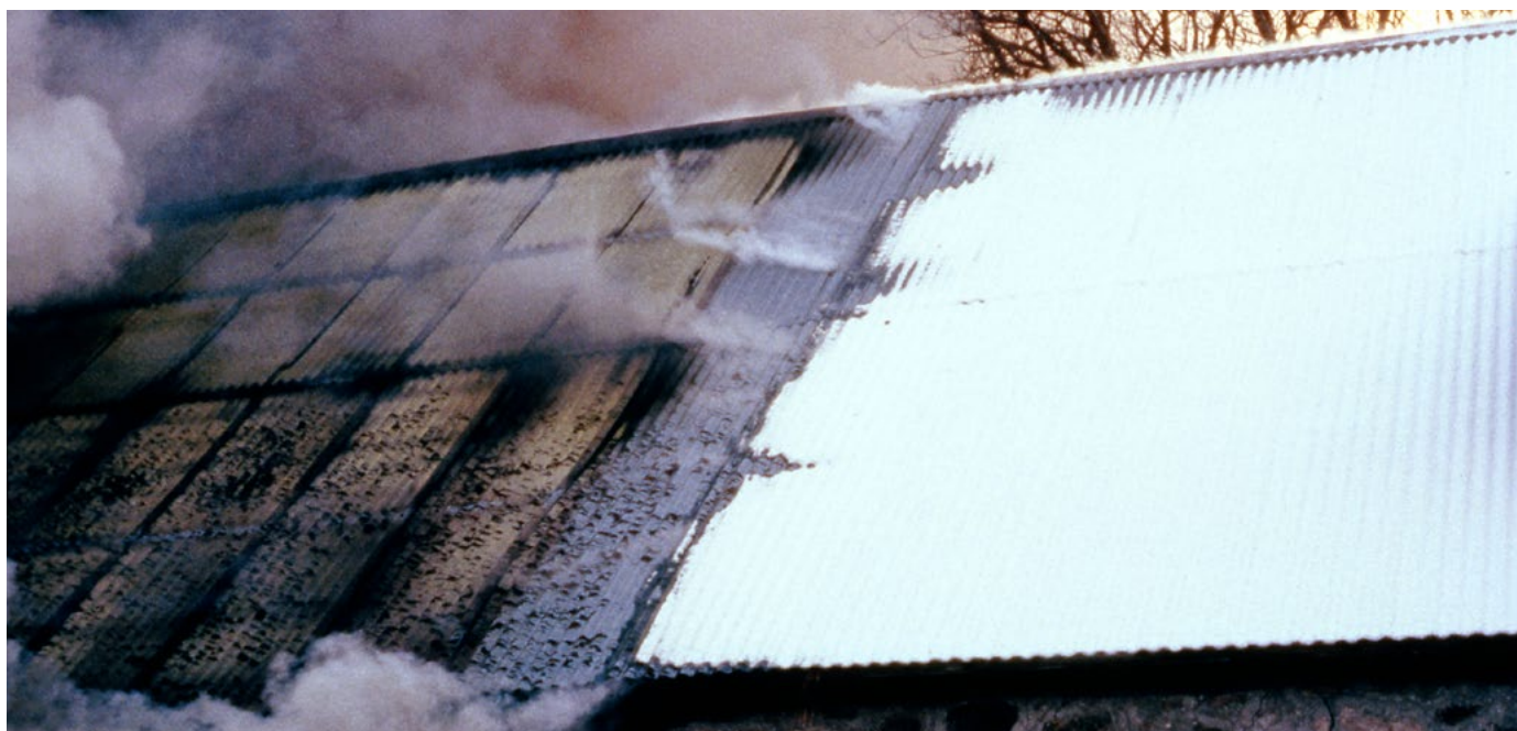
Här har det brunnit 15 minuter på ena sidan av en sektioneringsvägg.
