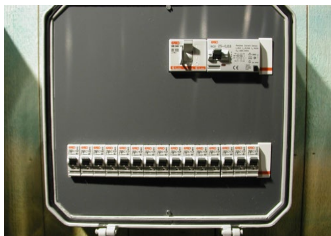
Elcentral med jordfelsbrytare. Om jordfelsbrytaren löser ut är det ett tecken på att något är fel. Är felet till exempel en trasig gummikabel är det bara att byta den. Men om det är fel i den fasta installationen måste du kalla på din elinstallatör.
