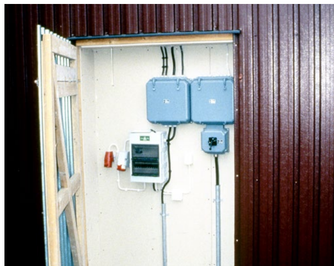
Elcentral infälld i vägg. Utrymmet är klätt med tändskyddande beklädnad.
